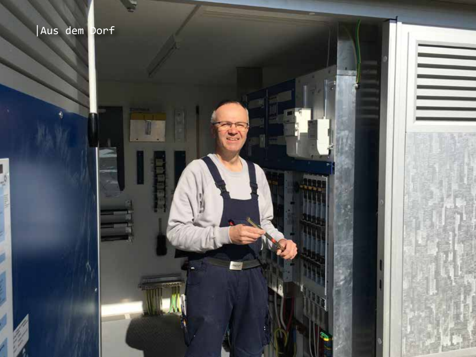
Heiner Motschi im Auftrag der EVO in der neuen Trafostation Hofacker.
